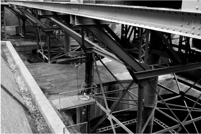
De zuigers onder de liftbak waarop de scheepslift steunt.
